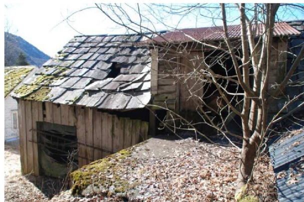
Figur 6 Tilstanden på løa er dårleg og gjer ho til ei fare for tryggleiken for folk og dyr i tunområdet
