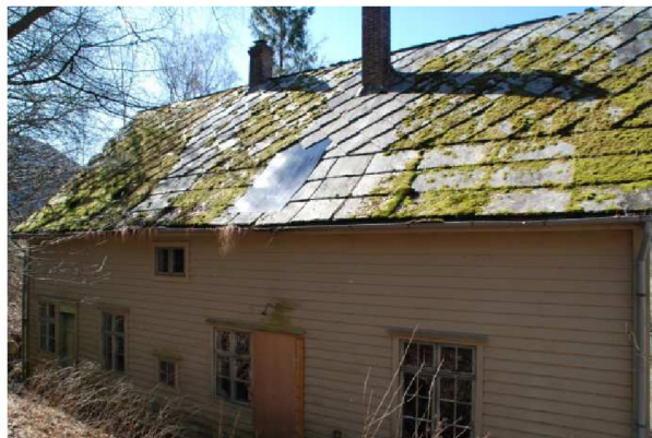
Figur 11 Taket på våningshus 2 vil trenge omlegging ved ev. restaurering/rehabilitering
