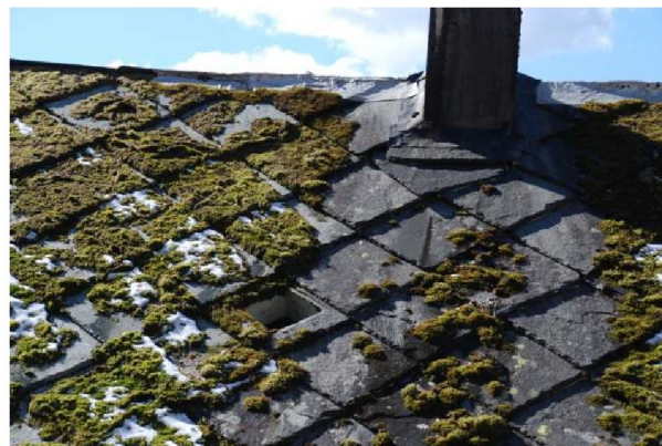
Figur 9 Takluka som har stått open gjennom fleire år har medverka til omfattande vatnskader i huset
