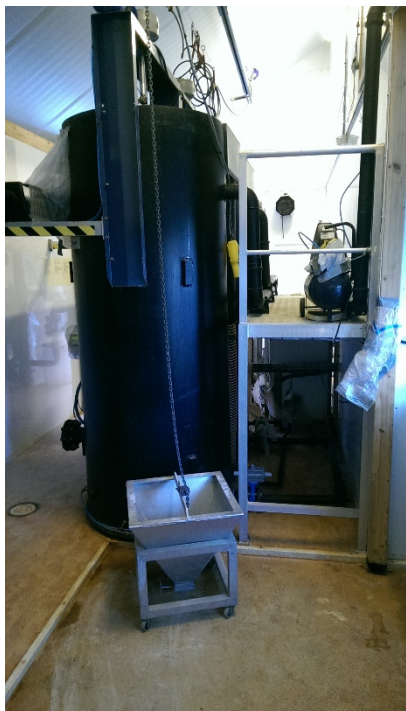
Figur 3-7: Marmorfilteranlegg ved Uggdal vasshandsamingsanlegg.
