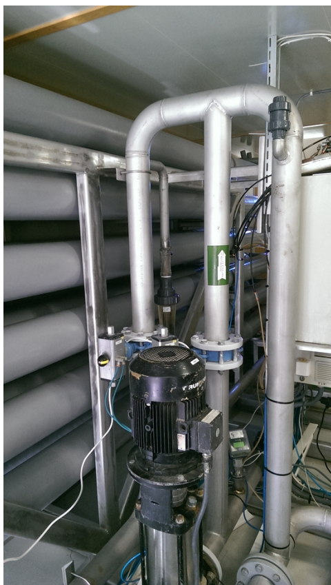
Figur 3-2: Membranfiltreringsanlegg ved Tysnes vassbehandlingsanlegg.
